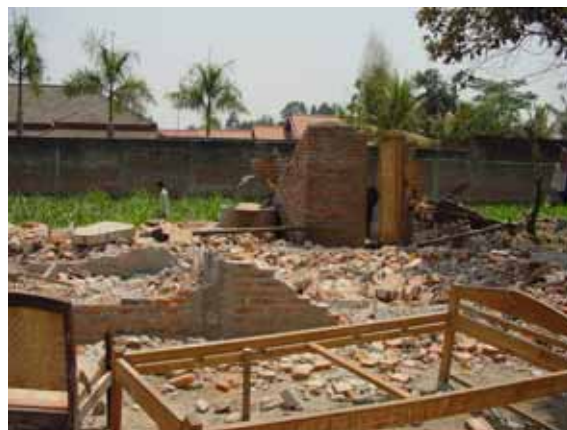
写真 - 8 倒壊した建物の様子
