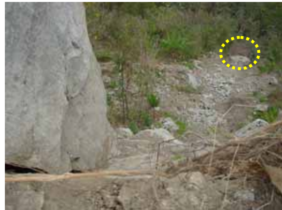
b) 崩落した岩塊
