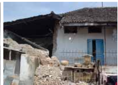
写真 20 倒壊したタルム
