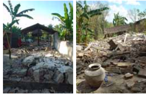
写真 1、2 倒壊した煉瓦造の住宅
