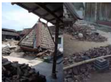
写真 19 倒壊したブンドポとその柱脚
