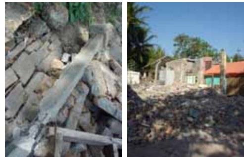
写真 3、4 鉄筋があるが壊れた住宅
