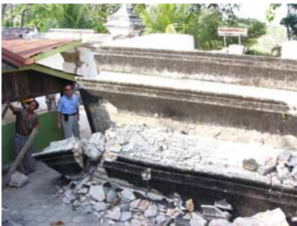
図 - 4 南東墓石の入口門の倒壊
