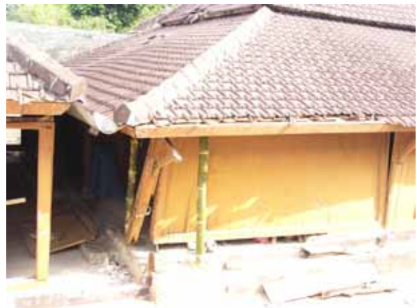
図 - 13 墓石北端部の小屋被害(柱根本はアンカーで固定)
