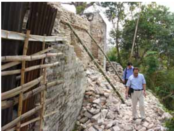
図 - 12 墓石群北端(頂上部)での被害
