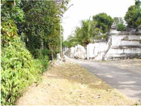
図 - 3 南東隅部擁壁の崩壊
