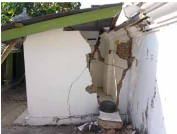
図 - 5 入口門に東隣接の小屋被害
