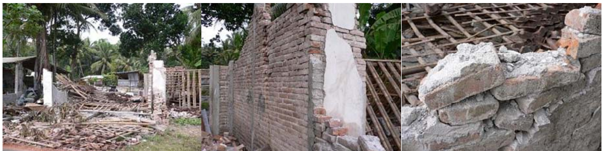
写真-15 倒壊家屋の構造（Pandak）
