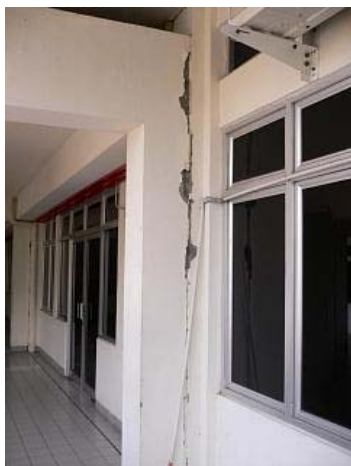
写真-2 UGM の建物に発生したクラック
